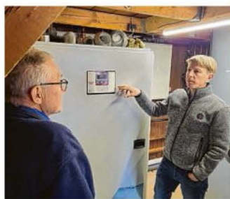
Ingenieur Ralf Büchele (rechts) erklärt, wie die Warmwasserbereitung funktioniert.
